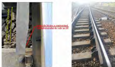
Fotografia nr.4 - urmele lăse pe schimbătorul de cale nr.10 de roțile deraiate
