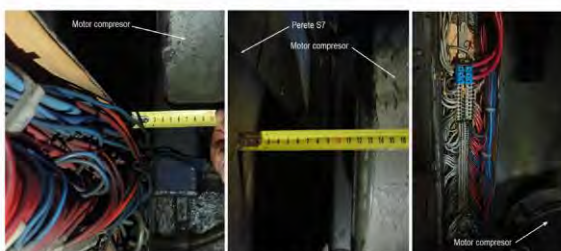
Foto nr. 7. Distanța de la cassetă rulmentului la blocul de aparate S7 și la placa de borne.
